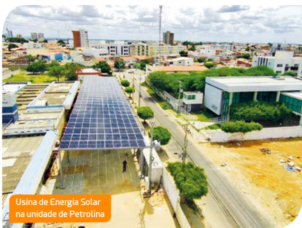
Inauguração da Usina de Energia Solar na unidade de Petrolina
